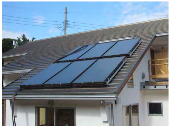
ソーラー給湯集熱器 奥は太陽光発電パネル
