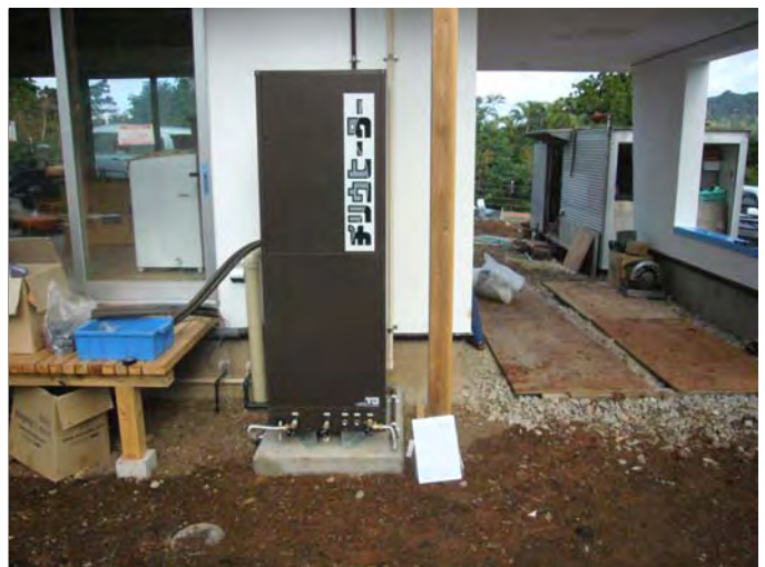
ソーラー給湯貯湯タンク (チリウヒーター製)
